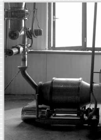
Сернистая печь станции сульфитации / Sulfur burner of the sulfitation station
