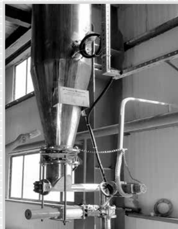
Шнек-дозатор для подачи серы в печь. / Dosing screw for feeding sulfur into the burner.
