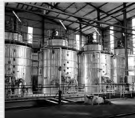
Вакуум-аппараты на сахарном заводе La Belle в Алжире / Batch vacuum pans mounted at La Belle Sugar Refinery in Algeria
