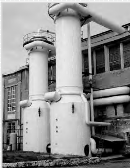
Выпарные аппараты на Гайсинском сахарном заводе / Evaporators installed at Gaisyn Sugar Plant
