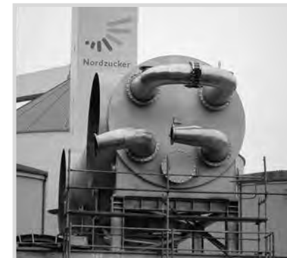
Подогреватель диффузионного сока ПДУ-1236 на заводе Nordzucker AG / Raw juice heater TPDU-1236 mounted at the Nordzucker refinery
