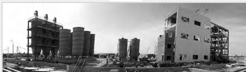
Металлоконструкции для цеха по производству КФ-смолы (г. Коростень, Украина) / Steel Structures for UF-Resin Production Facility (Korosten, Ukraine)
