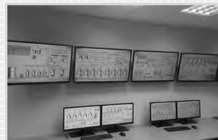
Операторская центрального диспетчерского пункта на Скидельском с.к. / Operator's room at Skidel's Sugar Factory
