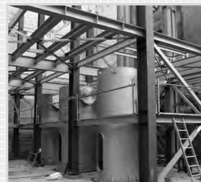
Металлоконструкции БРУ для Захарни Заводи АД (Болгария) / BRU Steel Structures for Zaharni Zavodi AD (Bulgaria)
