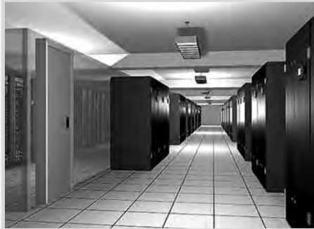
Машинный зал ЦОД “Парковый” / Control room of Parkoviy Data Center
