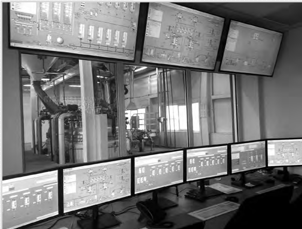
Операторская цеха КФС на Коростенском заводе МДФ (Украина) / Operator's room of UF-Resin Plant at Korosten MDF Plant (Ukraine)
