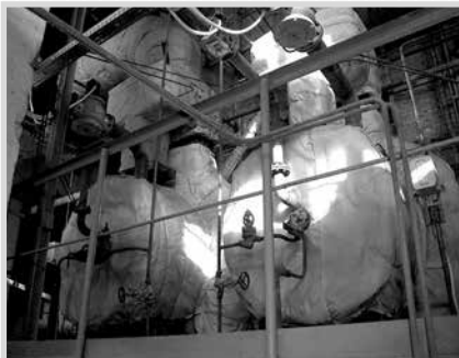
Горелки после перевода на сжигание ВУТ / Burners after transferring to coal-water fuel burning
