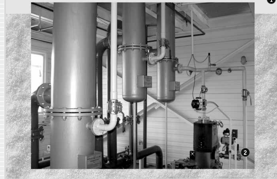
1. Структура системы учета спирта / Scheme of Spirit Metering System 2. Конденсаторы воды со следами этанола (ГП "Ивашковский спиртзавод") / Water Condensers with ethanol drops (SE Ivashkivskiy Distillery)
