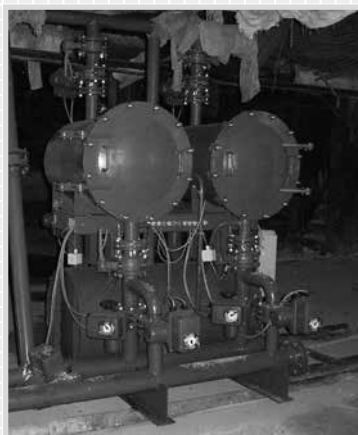
Фильтры производства "Техинсервис" на Владимир-Волыньском с.з. / Techinservice filters at Volodymyr-Volynskiy Sugar Plant
