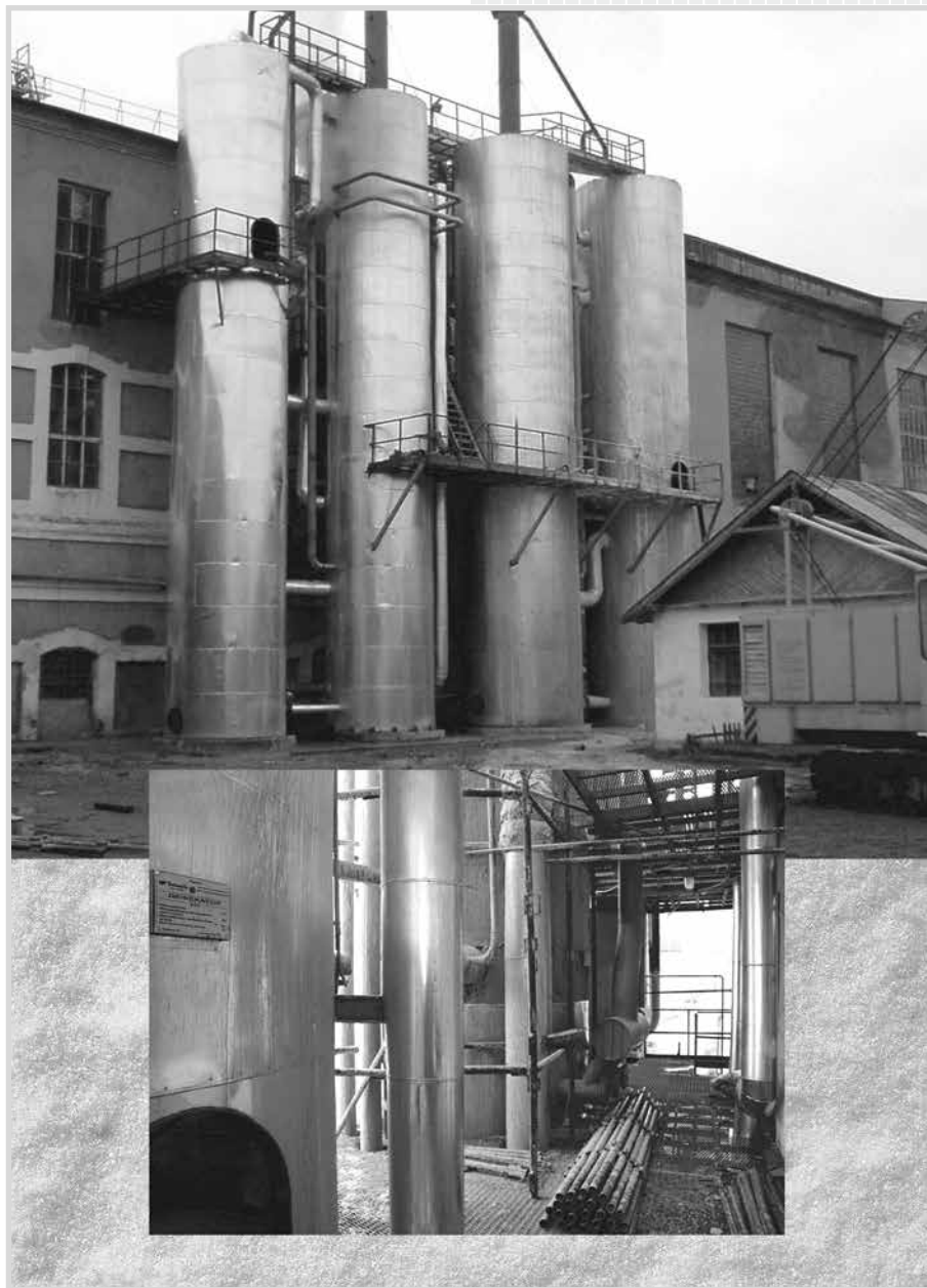
Станция дефекосатурации (Погребиченский с. з.) / Purification Plant (Pogrebishchenskiy Sugar Factory)
