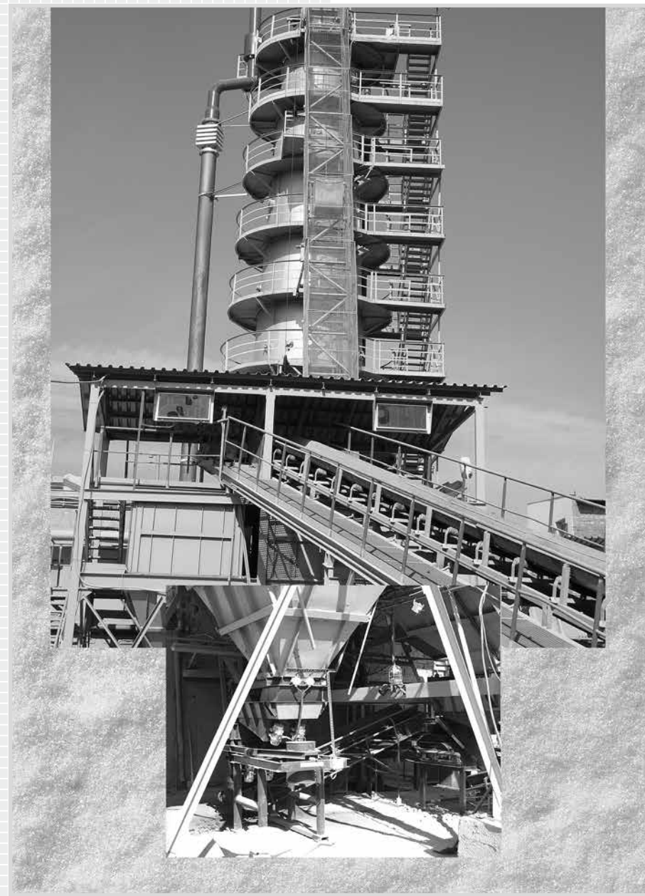
Линия подачи шихты / Charge Feeding Line
