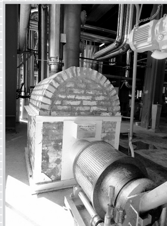
Камера догорания сернистой печи / Sublimation chamber of the sulfur burner
